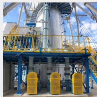
排煙脱硫装置
