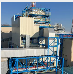
ボイラー本体
